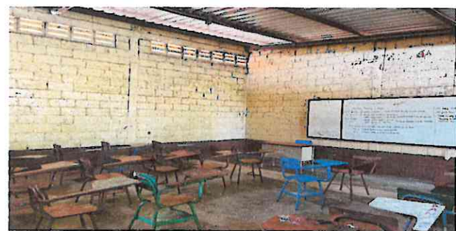
Foto 3: Pintura de interior en mal estado en paredes de salones de clases
