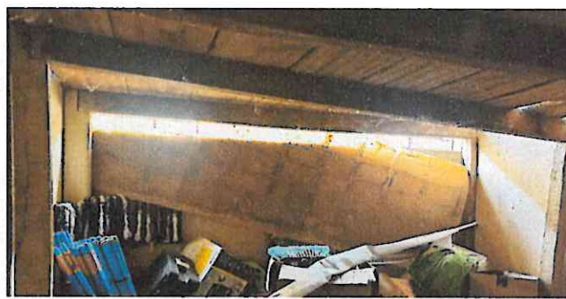
Foto 2: Deterioro de ventana
