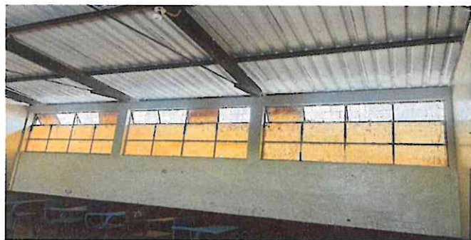
Foto1: Ventanas en mal estado por la antigüedad de la infraestructura
