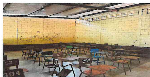
Foto 4: Pintura en interior deteriorada en paredes de salones de clases
