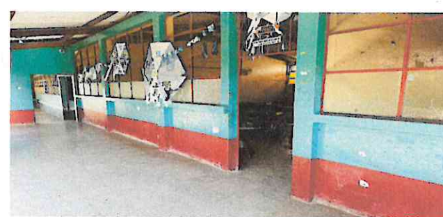
Foto 6: Pintura de exterior deteriorada
