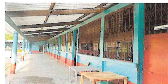
Foto 5: Pintura de exteriores dañada por el paso del tiempo
